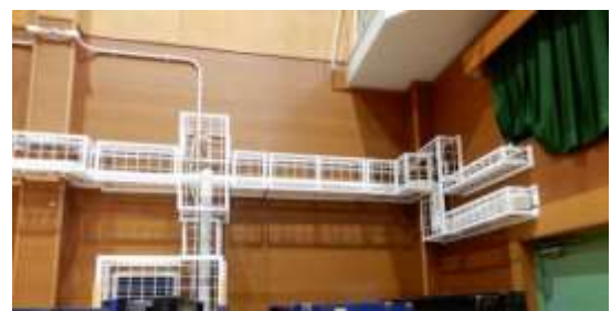
(写真3) 配管の防球状態
