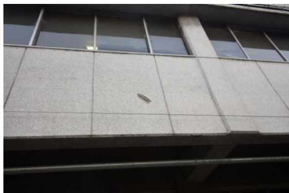
図 1-2 本庁舎老朽化の状態①
