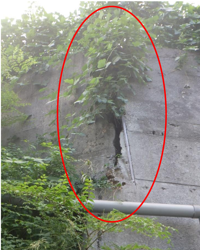
(擁壁_クラック箇所)
