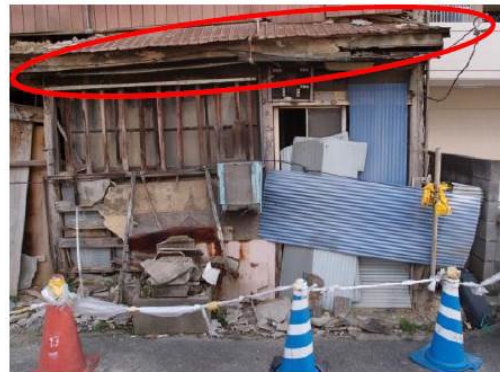
軒に不陸、剥離が生じている
