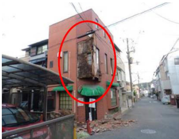
外壁が破損している
