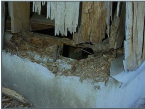
蟻害が発生し欠損している
