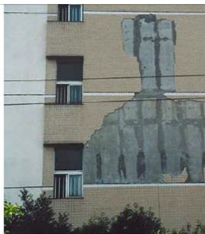
外壁に脱落が生じている
