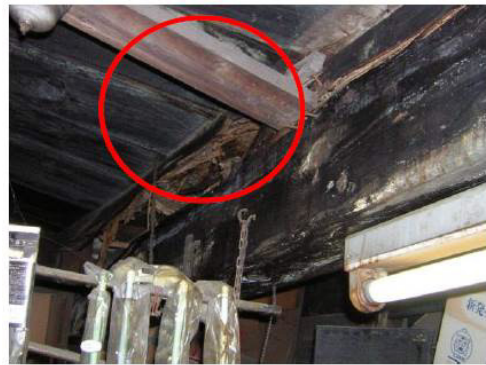
はりの破損、腐食などが発生している
