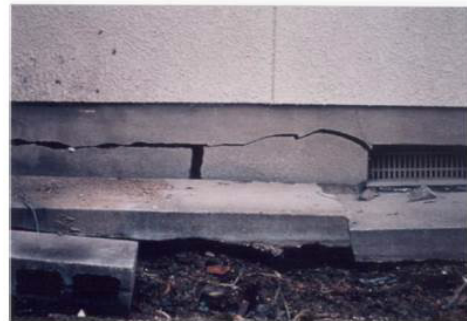
基礎が大きく破損している
