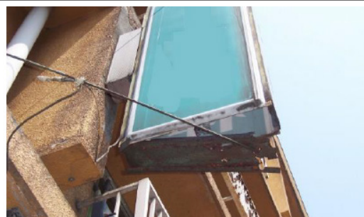
底板に腐食が生じている
