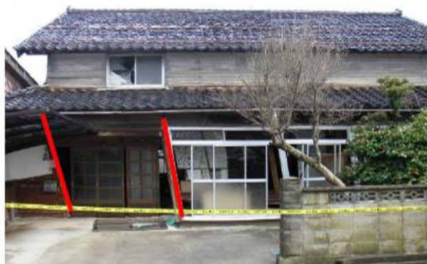
1階部分が傾斜している
