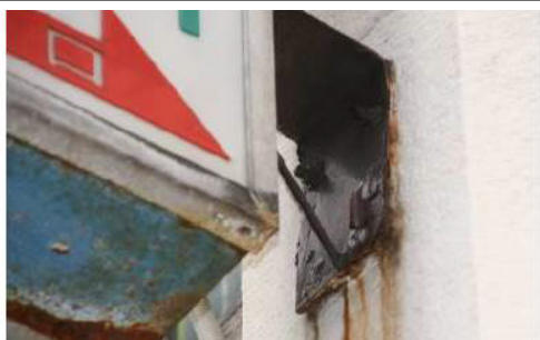
支持部分に著しい腐食が生じている
