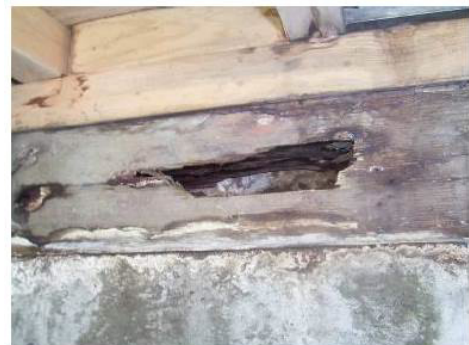
土台に蟻害が発生している
