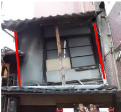
2階部分が沈み込み全体的に傾斜している
