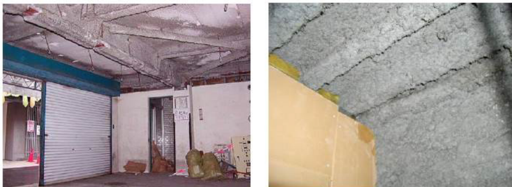
吹付アスベストなどが飛散し、暴露する可能性が高い
