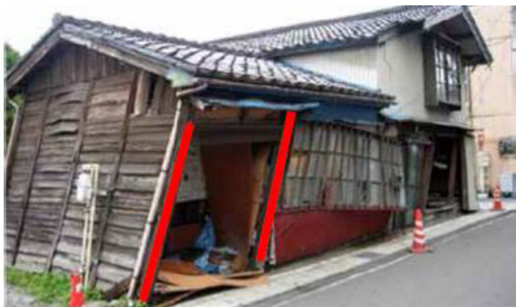
外壁が大きく傾斜しており、建具や窓枠がはずれ、原型を留めていない
