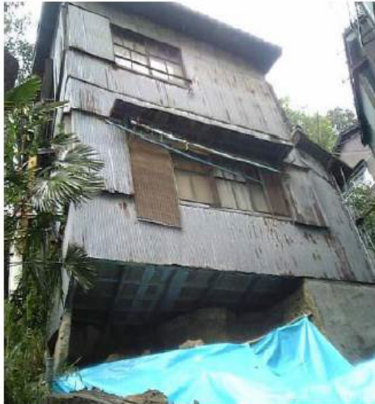
基礎が大きく欠損している (台風の影響による被害)
