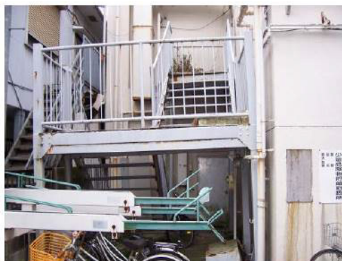
屋外階段が傾斜している
