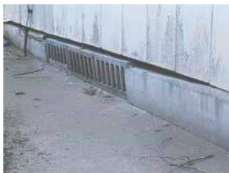
基礎が沈下し破損している
