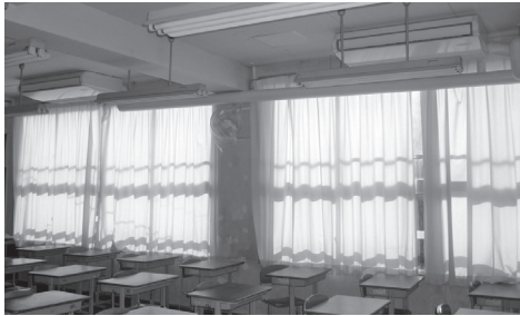
●既に設置している堅下北中空調設備
